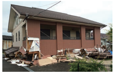
数回の地震によって、強度が徐々に低下した新耐震の建物は、倒壊こそしていないものの大きなダメージを受けた。
