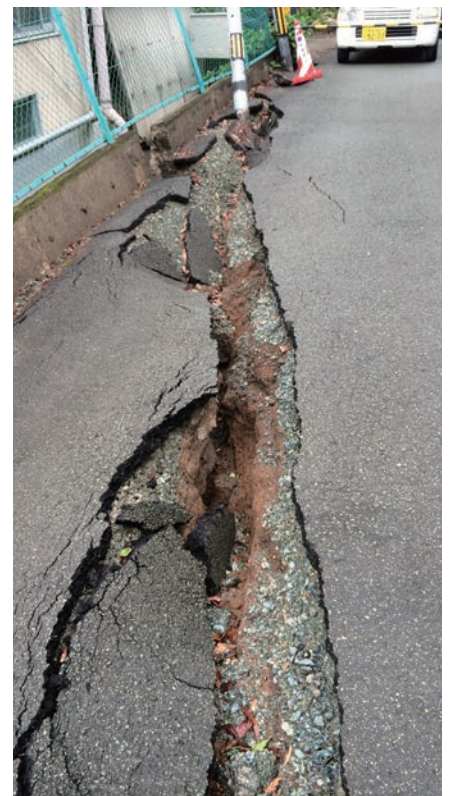
益城町近くで見られた地割れ。
