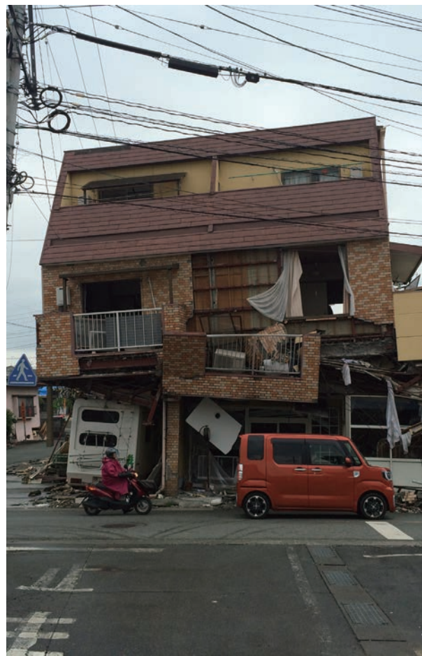
4階建ての建物が倒壊し、3階建てのようになってしまった様子。 地震の恐ろしさをまざまざと見せつけられる。
