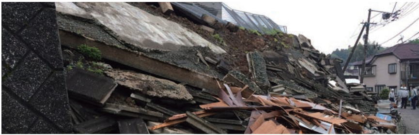
たび重なる激震によって、間知擁壁は甚大な被害を受けた。
